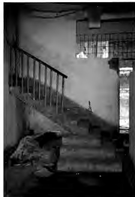
ENESTE UTVEI: Denne trappa er fabrikkens eneste rømningsvei og transportvei for varer.
